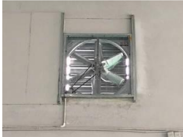
车间通风装置
